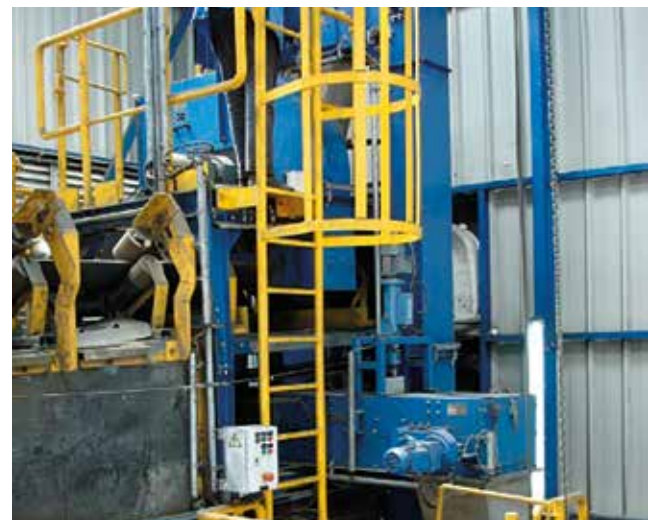
Instalación para la toma de muestra de concentrado de cobre
